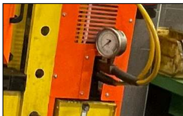
Ejemplo de acometidas en buen estado.
